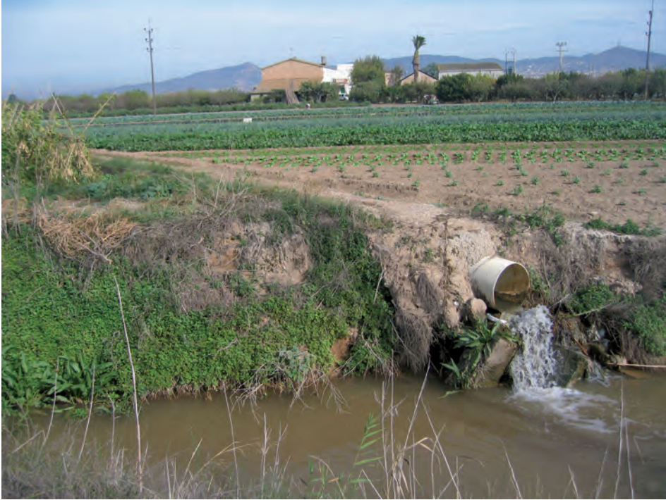
FIGURA 57. Aprofitament de l'aigua sobrant d'una fillola. En la imatge, s'hi observa el retorn cap al mateix canal de la Dreta, de l'aigua procedent d'una fillola que, un cop fet el seu recorregut, es troba el canal de la Dreta i torna l'aigua que uns centenars de metres abans ella mateixa havia captat. Al fons podem veure la masia de Cal Tombarella, situada a la zona del Riu Mort de Sant Boi. En aquesta zona hi havia circulat en el passat un antic braç del riu Llobregat, d'aquí el nom de Riu Mort .
