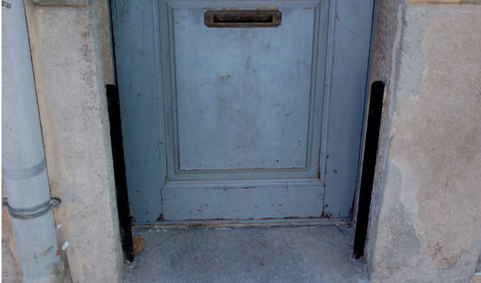
FIGURA 27. Batiport situat en un portal d'una casa del barri la Riera de Cornellà. Aquest barri, juntament amb el d'Almeda, van ser molt castigats durant el desbordament del Llobregat el vespre i la nit dels dies 20 i 21 de setembre de 1971. A manera de bagant o comporta, els veïns posaven taulons entre les ranures metàl·liques per tal d'evitar que l'aigua els entrés a casa. A dia d'avui encara trobem batiports a Cornellà, Sant Joan Despí o Sant Boi.
