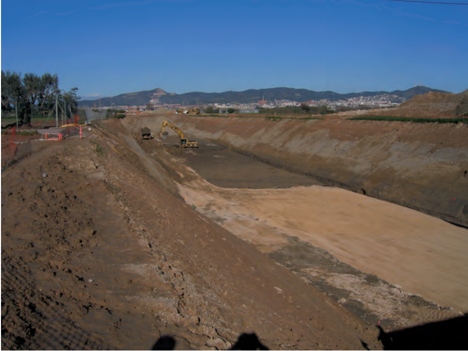
FIGURA 77. Les grans obres dutes a terme han posat al descobert els nivells superiors del delta del Llobregat, com aquesta trinxera oberta perquè hi circuli l'AVE. El Delta és un territori molt fràgil, amb materials tous i poc consolidats i amb un nivell freàtic molt alt.
