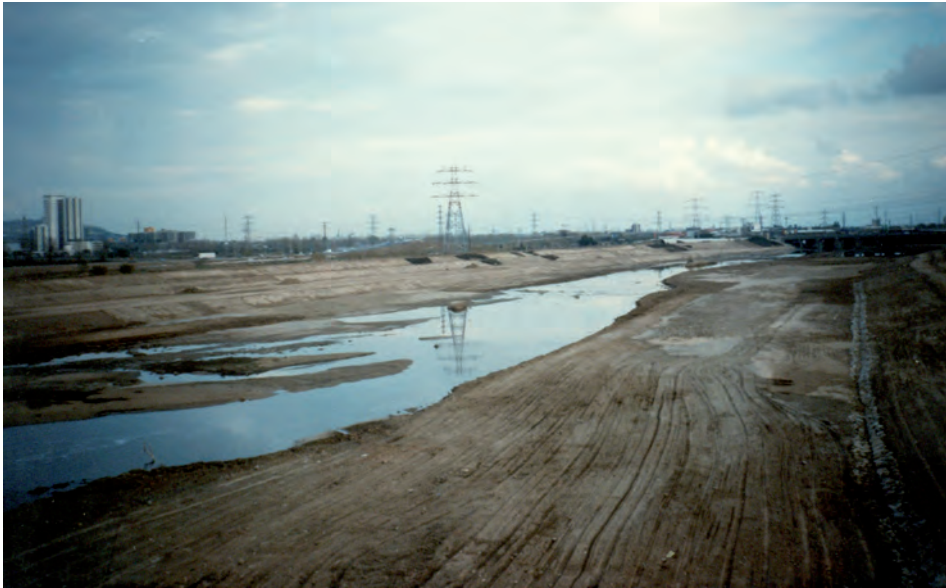
FIGURA 68. Estat del llit del riu Llobregat després de ser buidat de tot tipus de vegetació i de materials superficials en el moment de la construcció de la Pota Sud. El llit del riu ha estat objecte de tot tipus d'intervencions i aprofitaments, que massa sovint són una clara espoliació dels recursos naturals, necessaris per a l'equilibri ecològic de la dinàmica del riu.
